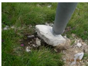
Fig. 7: esempio di rotazione e traslazione verso valle della fondazione del montante di reti fermaneve
