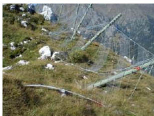
Fig. 4: esempio di completa estrazione dell'ancoraggio di monte di una rete fermaneve
