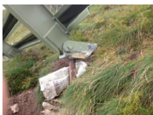
Fig. 6: esempio di cedimento del plinto di fondazione sul puntone di un ponte da neve
